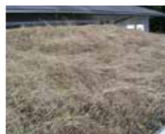
雑草が繁茂し植栽が被圧され衰退
