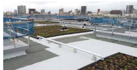
植栽帯外を横断する部分には、塩ビ管に凍結防止の保温措置を施した渡り配管を用います。
